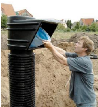
Mise en place du filtre G 4
