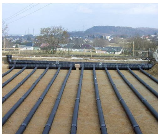
■ Installation pour bâtiment tertiaire
